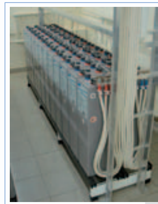
Рис. 18 Смонтированная батарея A600 OPzV
