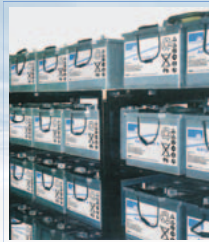
Рис. 14 Смонтированная батарея A400
