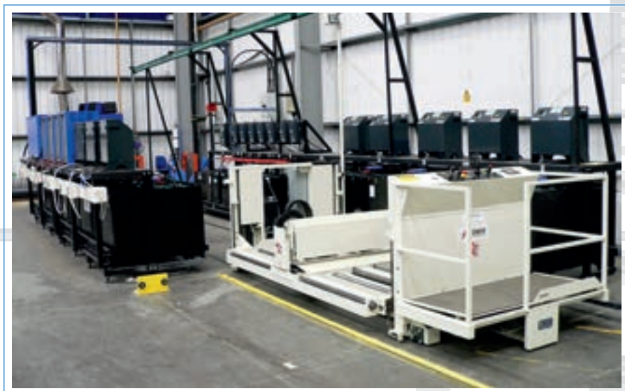
Система автоматизированной замены батарей
